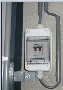
VOORBEELD ZEKERINGSKAST IN DE UNIT
